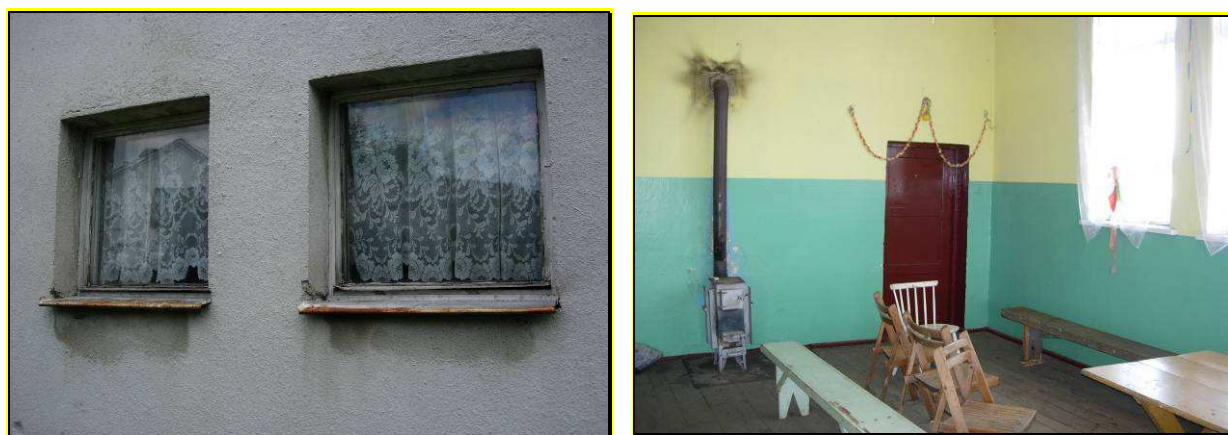
Ryc. 7 Budynek świetlicy wiejskiej – stan stolarki okiennej i wnętrza sali głównej (fot. P. Dahlke)
